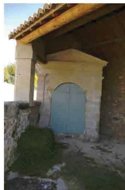
Abreuvoir (?) envahi par la végétation au premier plan, en arrière plan : bâtiment abritant les pompes. © Jennifer Gomez (2007).
