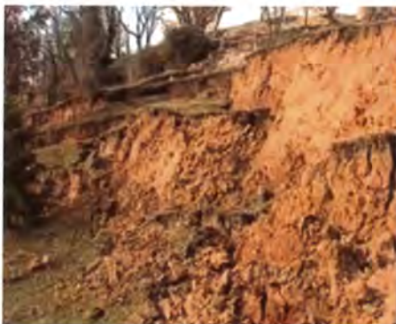
Niche d'arrachement © France 3
