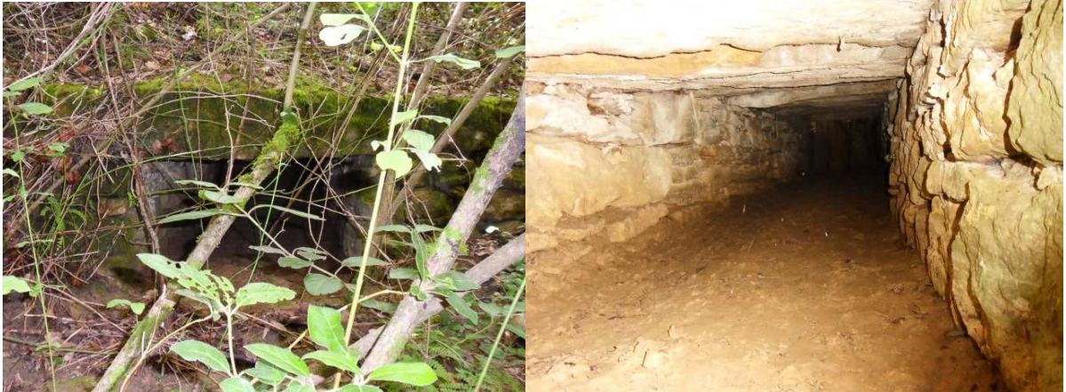
Tunnel d'écoulement des eaux sous le chemin, vers le ruisseau (section h 60cm x l 80 cm)
